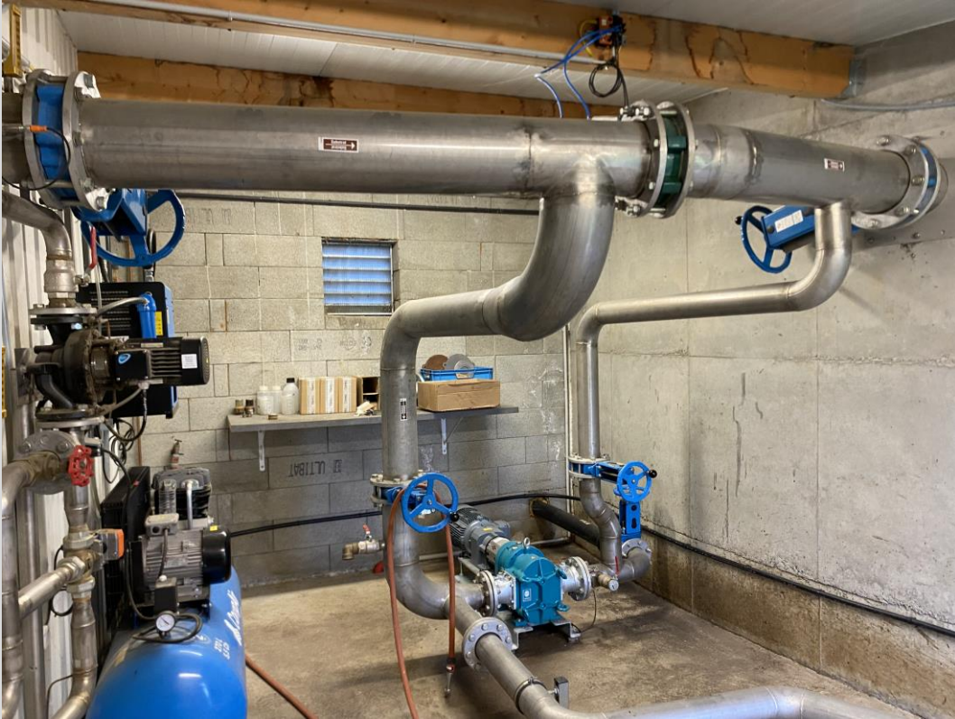
3) Liaison des deux cuves et évacuation du digestat.
