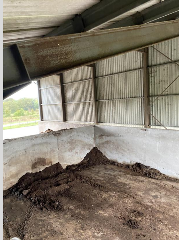
4) Point de stockage du digestat solide.
