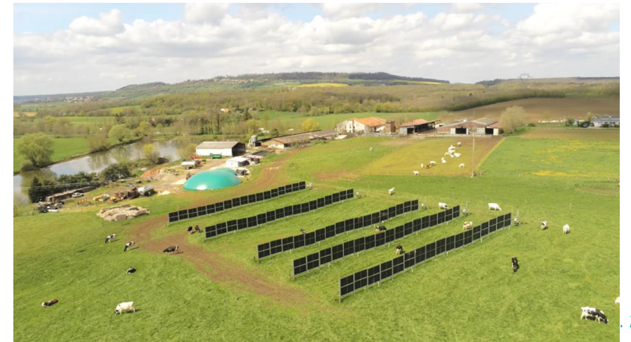
Panneaux bifaciaux verticaux
